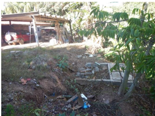
Figura 13. Degrau de abatemento no terreno, causado por solapamento de margem do córrego (SP_JUNDIAI_SR_17_CPRM)
