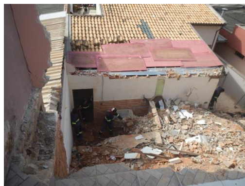
Figura 16. Residência localizada à Rua Jataí, que foi atingida por muro e pelo talude, destruindo pequena edícula
