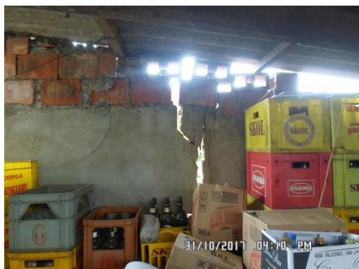
Figura 7. Trinca em parede causada pela movimentação do terreno (Fonte: Defesa Civil Municipal) (SP_JUNDIAI_SR_2_CPRM)
