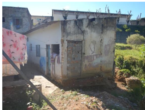
Figura 14. Casa trincada e abandonada devido o solapamento da margem do córrego ao lado da residência (SP_JUNDIAI_SR_22_CPRM)
