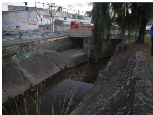
Figura 15. Córrego da Colônia, canalizado e com várias pontes em seu curso urbano, podendo potencializar eventos de cheias, caso a vazão não esteja adequadamente dimensionada (SP_JUNDIAI_SR_29_CPRM)
