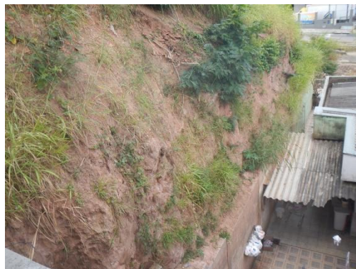
Figura 6. Moradia construída agregando métodos construtivos de corte e aterro, gerando talude vertical de grande amplitude (SP_JUNDIAI_SR_15_CPRM)
