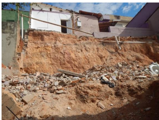
Figura 15. Fundos de residência localizada à Rua Ibiporã que teve seu muro colapsado pela força das águas
