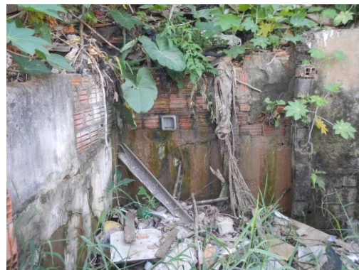
Figura 10. Infiltração de água proveniente do topo da encosta em casa parcialmente demolida pela prefeitura (SP_JUNDIAI_SR_4_CPRM)
