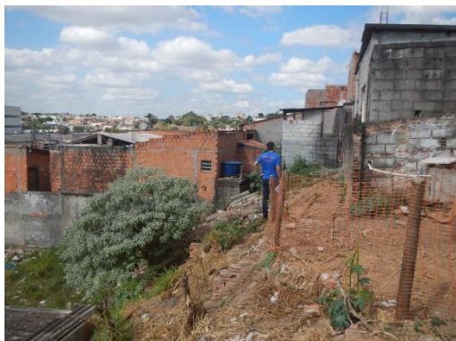
Figura 5. Corte e aterro para implantação de residências. Local com entulho e lixo, potencializando o risco a deslizamento na encosta (SP_JUNDIAI_SR_3_CPRM)
